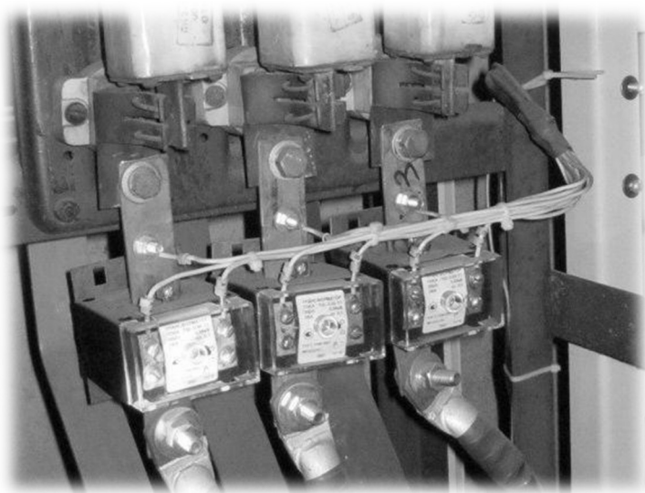
Рис. 1.6. Установка шинных трансформаторов тока
