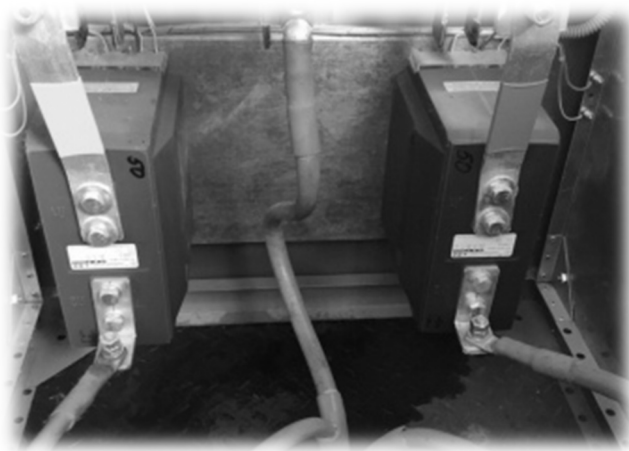
Рис. 1.10. Размещение опорных трансформаторов тока
