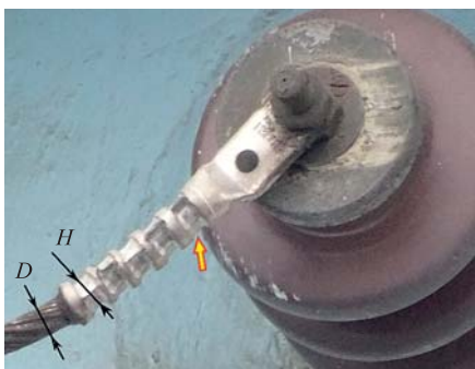
Рис. 4. Аппаратный зажим на проходном изоляторе к ЗРУ 35 кВ
