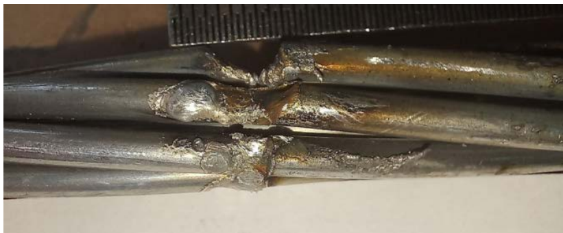
Рис. 4. Последствие межфазного замыкания
